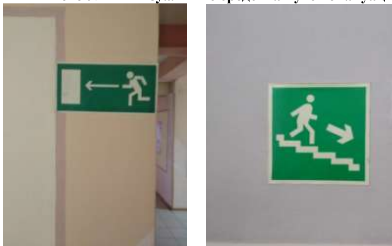
Фото № 17 Визуальные средства путей эвакуации
