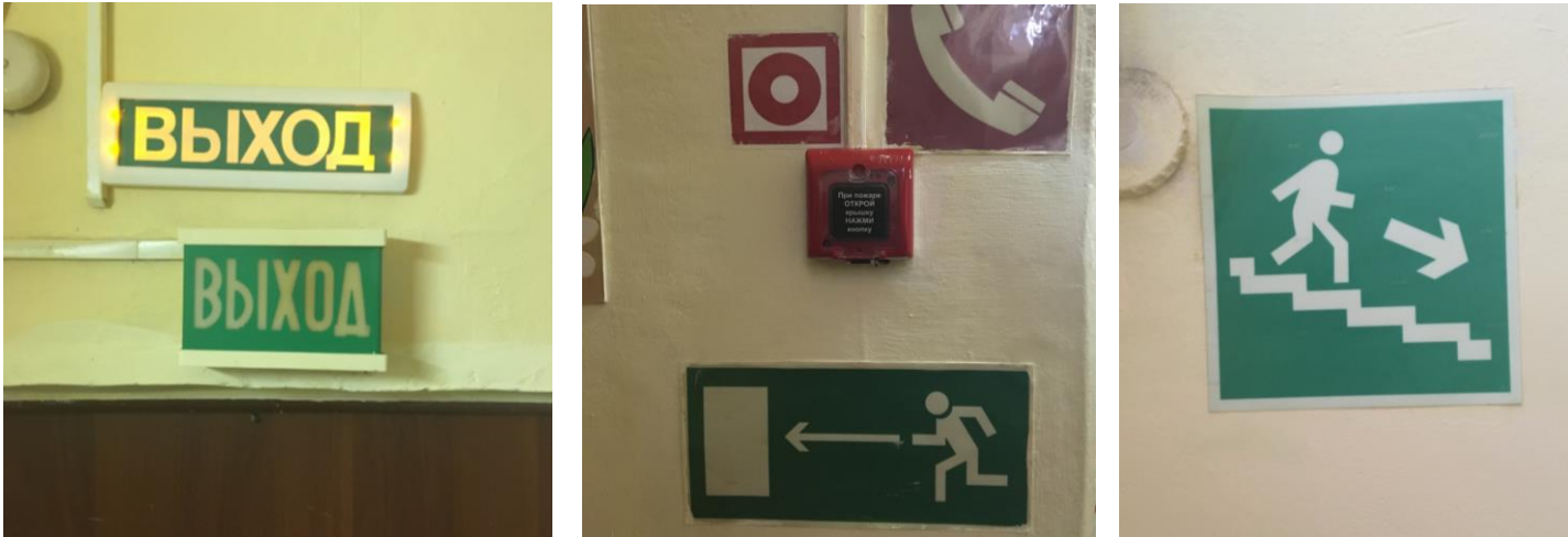
Фото № 18 Визуальные средства путей эвакуации
